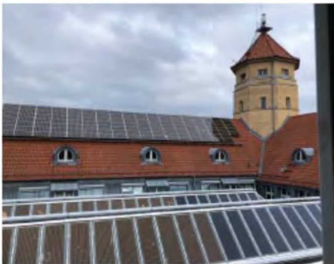
Photovoltaikanlage (auf Dach und in Dach) auf dem ZKM
